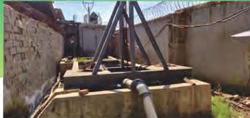
图：废水回收池
